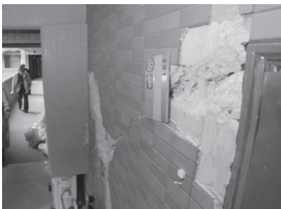
⑩ドア周りの非構造壁の被害（2005福岡県西方沖地震）：非構造壁に大きな亀裂が入り、タイルが剥離しています。
