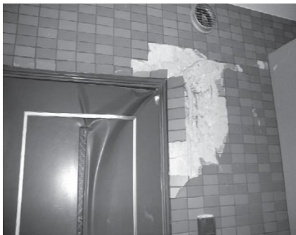
⑧ドア回りの非構造壁の被害（2005福岡県西方沖地震）：非構造壁の被害により玄関ドアが変形しています。
