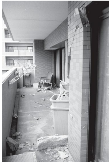
⑥ベランダ側の壁の被害（2005福岡県西方沖地震）：方立壁が崩れ破片が散らばっています。
