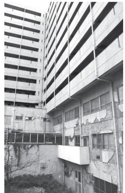
⑫外壁の被害（1995兵庫県南部地震）：低層階の外壁の仕上げ材が殆ど剥落しています。
