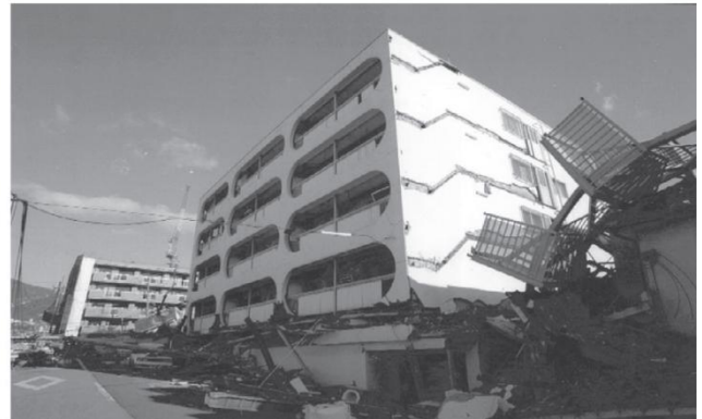
③1階ピロティの崩壊（1995兵庫県南部地震）：2階以上が住宅で壁があり、1階が店舗や駐車場で壁がない場合に1階が崩壊する被害が見られました
