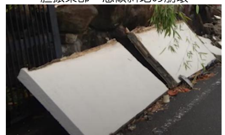
大阪北部・ブロック塀の倒壊
