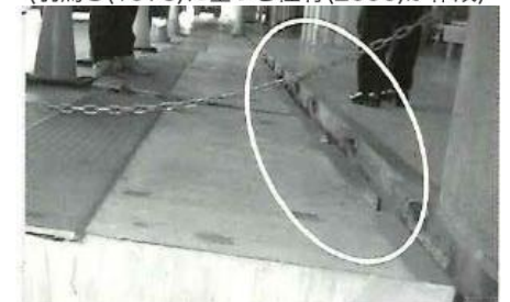
免震クリアランス部の仕上げの損傷
