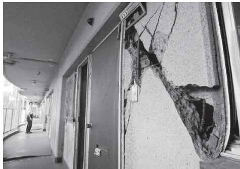
⑨ドア回りの非構造壁の被害（1995兵庫県南部地震）：壁が完全に崩落して鉄筋が剥き出しになっています。
