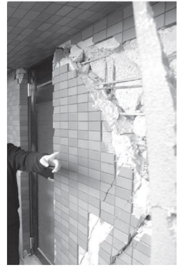
⑦非構造壁の被害（2005福岡県西方沖地震）：玄関側の非構造壁に大きな被害が生じています。
