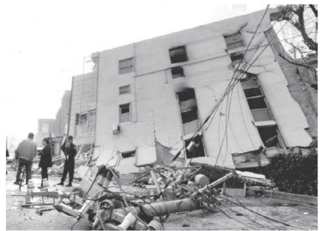
⑤マンションの倒壊（1995兵庫県南部地震）：著しく耐震性が低いマンションの中には、このような激しい壊れ方をしたものもありました。
