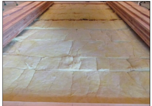
(4) 天井裏吸音材(グラスウール)の設置状況
