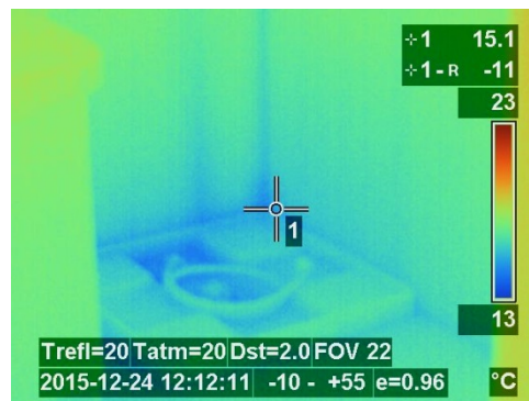
図 4. 2. 1-23 室内⑤ 1階寝洗面室北サーモ画像
