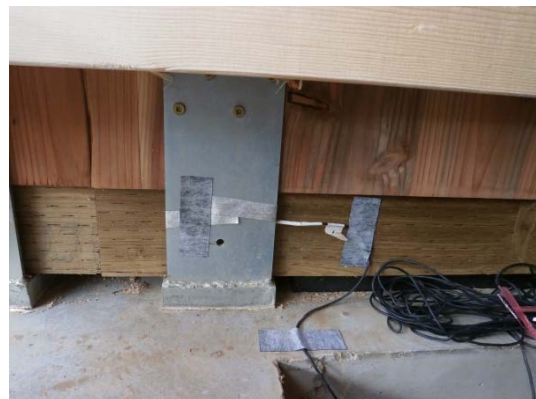
図 4. 2. 3-16 ④ 部室内側センサー
