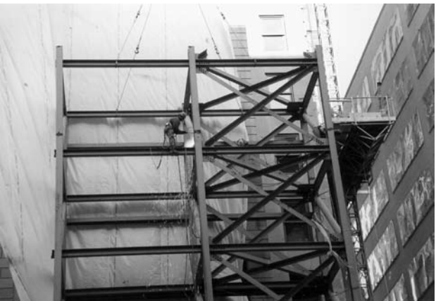
④既設外壁面の仮設養生構造物の解体、撤去作業中の状況
